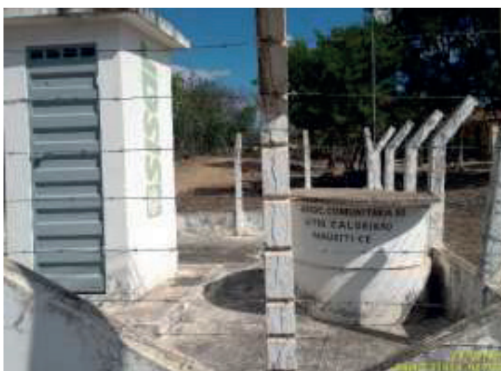
Sistema de distribuição de água da SISAR em Caldeirão
