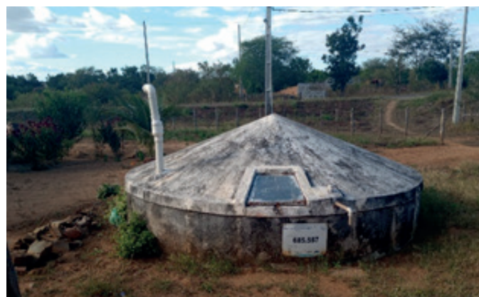
Cisterna na comunidade Boa Vista, Mauriti/CE
